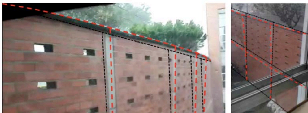
Figura 5. Deformación del muro al inicio del colapso visto desde dos ángulos diferentes (las líneas discontinuas negras indican la posición original en reposo. Las líneas discontinuas rojas indican la forma deformada al inicio del colapso)
