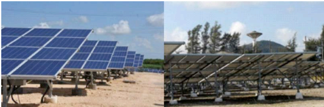
Figura 1. Parque solar fotovoltaico en Cuba (prototipo)
