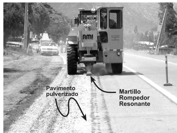
Figura 3. Equipo rompedor resonante para "Rubblizing" de pavimentos de hormigón en Camino Los Andes-Saladillo o Ruta 60- CH, Los Andes, Chile
