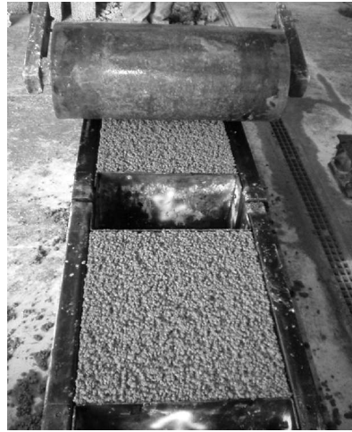
Figura 2. Compactación de las losetas en sus moldes Figure 2. Compacting small slabs in its molds
