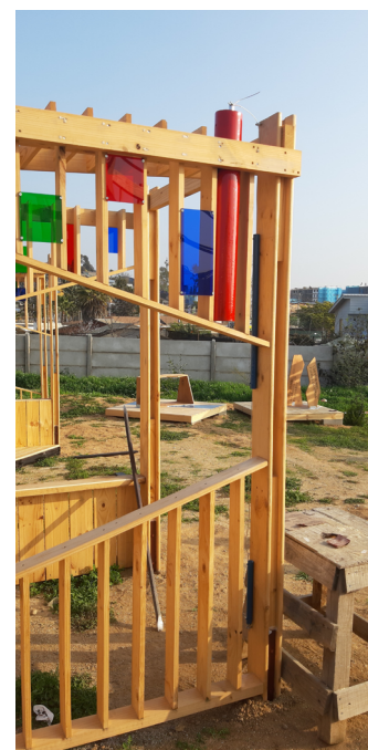
Figura 7. Fotografía de campana instalada en la celosía. Elaboración propia.
