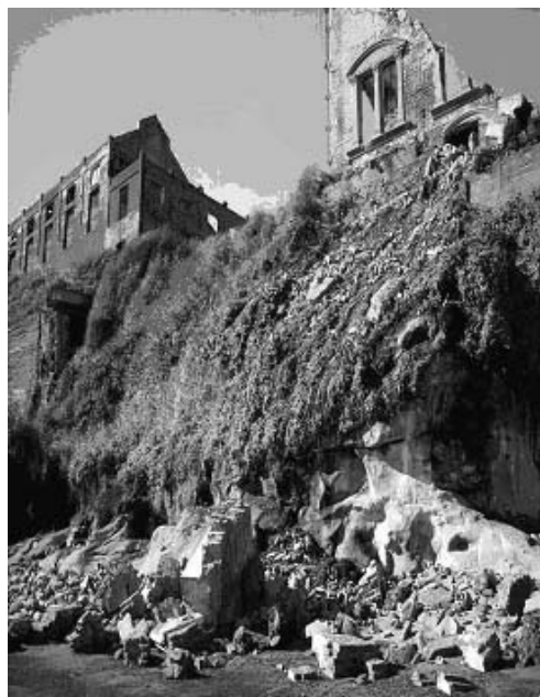
Figura N° 10 Remoción en masa en sector industrial pique Carlos
